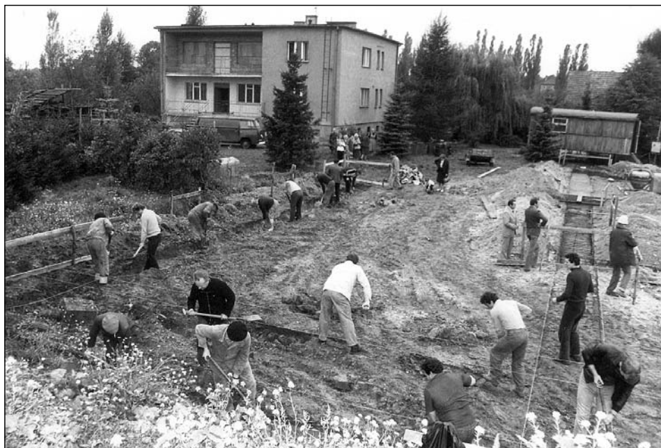
Budowa kościoła w Kobylnicy, w tle budynek plebanii, wspomniany w dokumencie UdSW (1981 r.). Zdj. ze zbiorów E. Tomaszewskiej.
